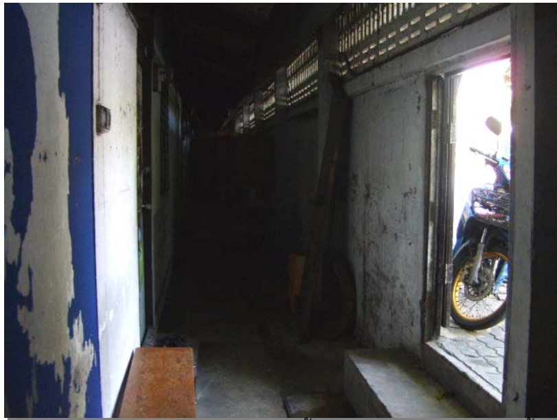
ที่พักคนงานครัว : สภาพภายในปิดทึบ อับชื้น อากาศถ่ายเทไม่สะดวก นำท่วมขัง
